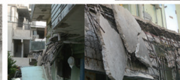
塩害が強く躯体の鉄筋を腐食させ爆裂を呈する環境が開発背景に。
